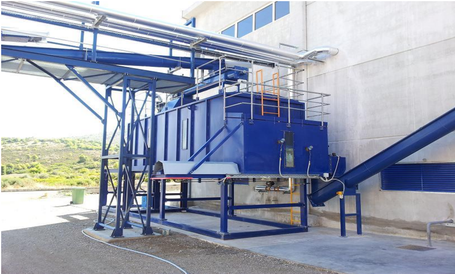
Σιλό και σύστημα μεταφοράς θρυμματισμένης βιομάζας
